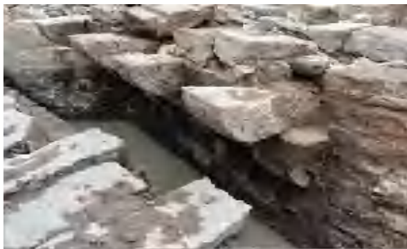
▲ 砖石构件，应注意是否会出现构件散落、局部坍塌失稳等结构问题
